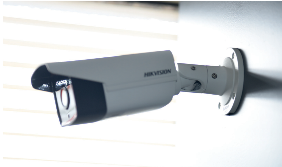
Eine Kamera, welche die BTS Sicherheit AG regelmässig einsetzt.
