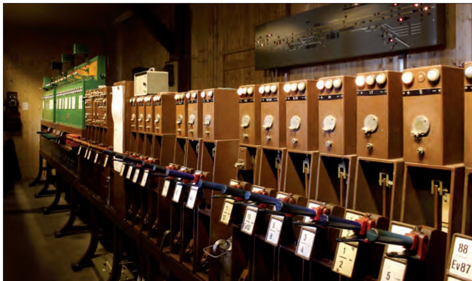
Das Wärterstellwerk Sursee, Baujahr 1913, in originaler Betriebsbeleuchtung
